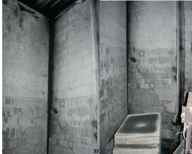
Figura 5: Vista dos danos na parede do fundo
